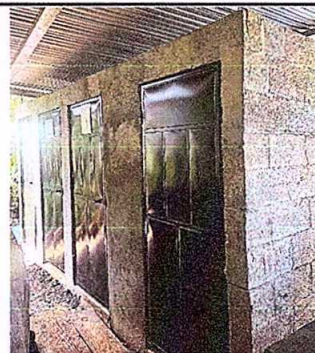
Foto 2: Baños en malas condiciones
