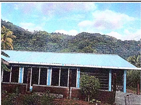
Foto1: Lámina en malas condiciones
