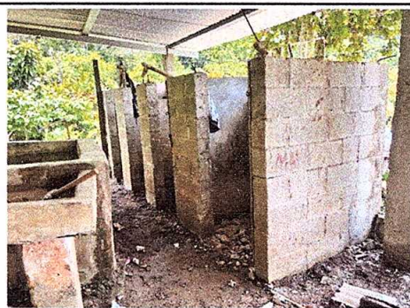
Foto 2: Baños en malas condiciones
