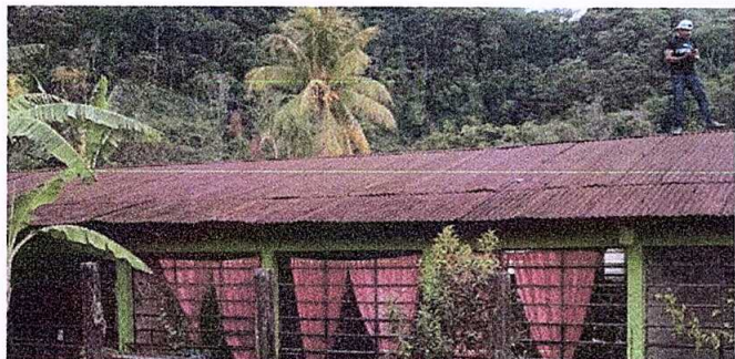
Foto1: Lámina en malas condiciones
