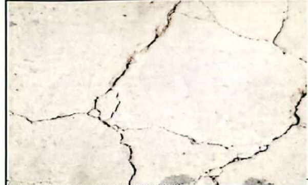
Foto 4: Sustrucción de torta de concreto
