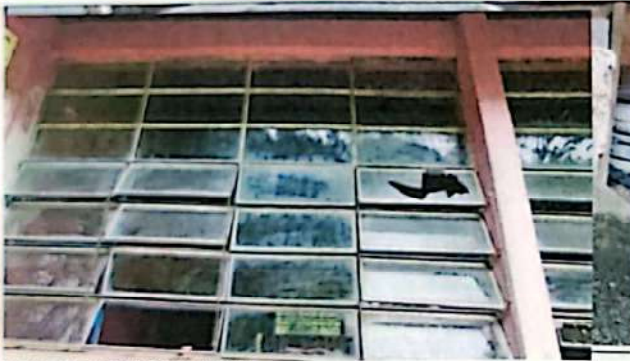
Foto 3: Sustrucción de vidrios
