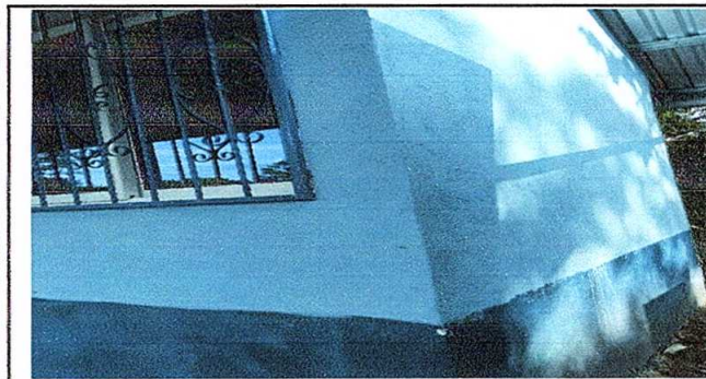
Foto 11: Las paredes necesitan mejoramiento en cerramiento.
