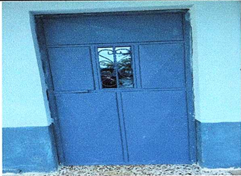
Foto 3: Sustrucción de puerta (2.10 m de alto * 90 cm de ancho).
