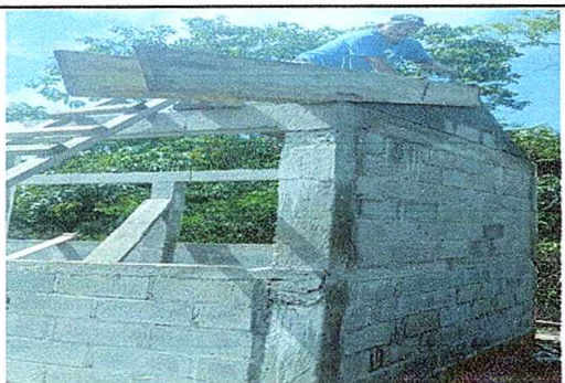
Foto 11: Las paredes necesitan mejoramiento en cerramiento.
