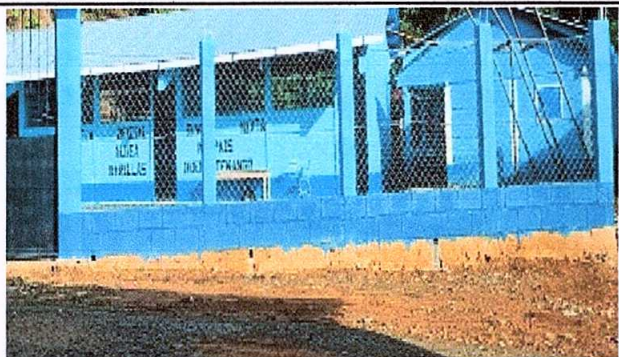
Foto 5: Muro perimetral dañado
