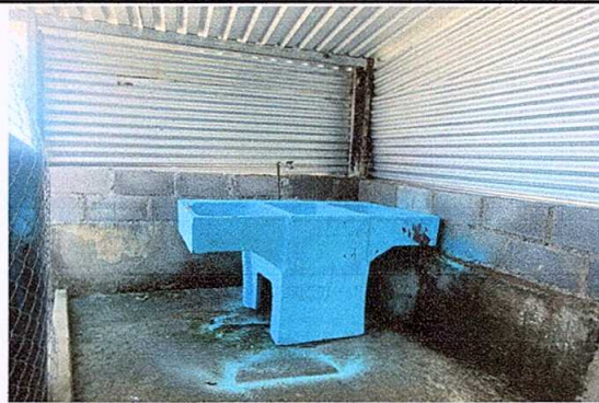
Foto 4: Sustitución de pila en malas condiciones
