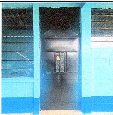
Foto 3: Puerta de cocina deteriorada
