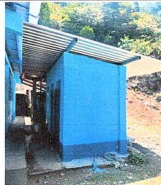
Foto 2: Soportes de madera en mal estado
