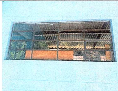
Foto 6: Vidrios de ventanas faltantes
