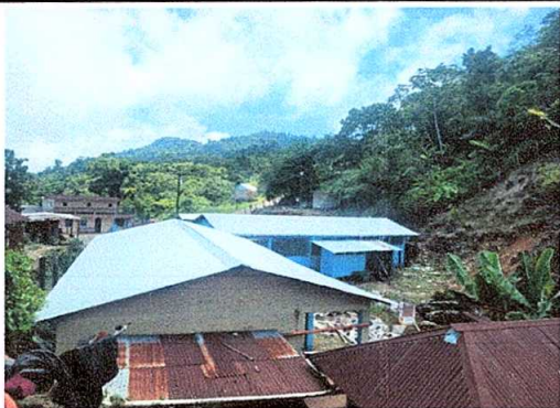
Foto 1: Lámina en malas condiciones
