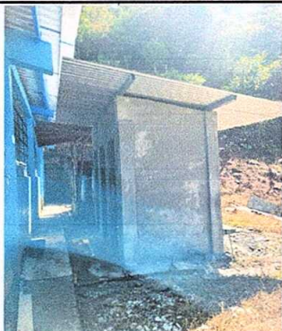
Foto1: Paredes de baños dañadas por el agua
