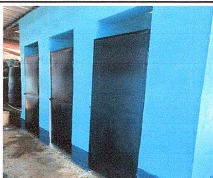
Foto 4: Puertas de baño en mal estado
