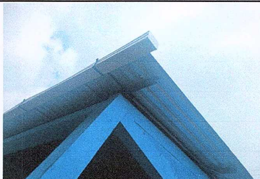
Foto 2: Canales y bajadas de agua en malas condiciones
