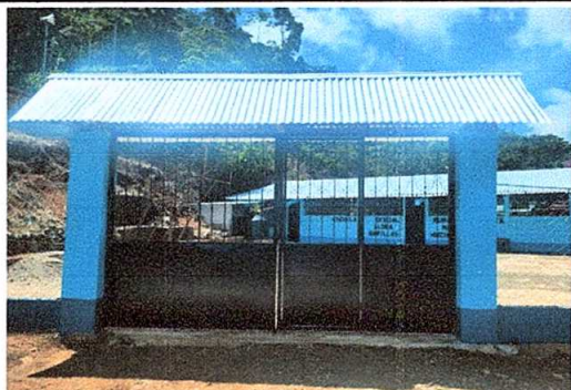
Foto 5: Porton en malas condiciones
