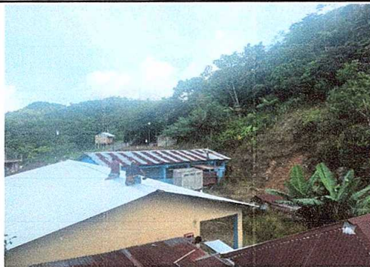
Foto1: Lámina en malas condiciones
