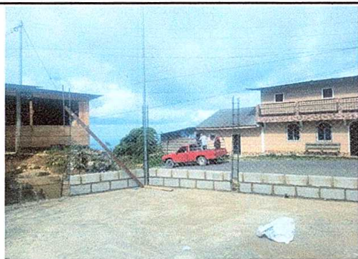
Foto 5: Muro perimetral dañado
