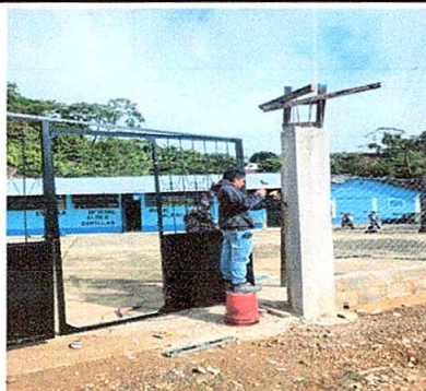
Foto 5: Porton en malas condiciones
