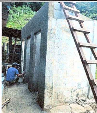
Foto 1: Paredes de baños dañadas por el agua
