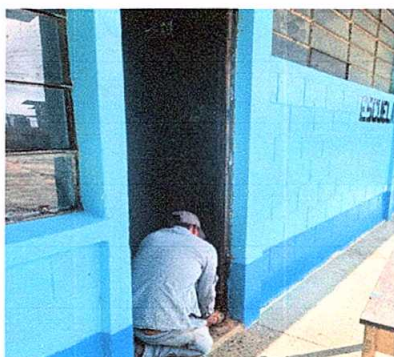
Foto 3: Puerta de cocina deteriorada
