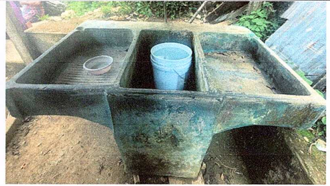
Foto 10: Sustitución de pila en malas condiciones
