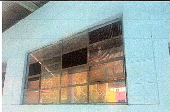
Foto 6: Vidrios de ventanas faltantes
