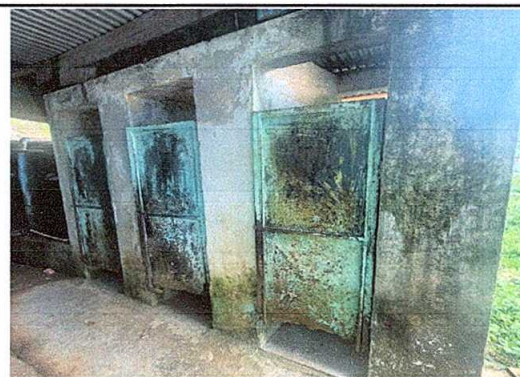
Foto 4: Puertas de baño en mal estado
