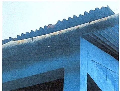
Foto 8: Canales y bajadas de agua en malas condiciones
