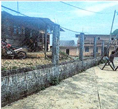
Foto 11: Muro perimetral dañado
