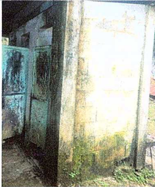
Foto 7: Paredes de baños dañadas por el agua
