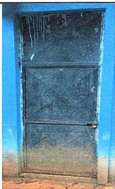
Foto 3: Puerta de cocina deteriorada
