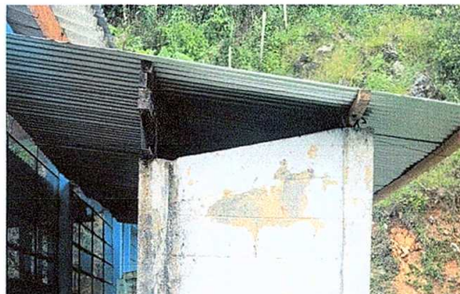
Foto 2: Soportes de madera en mal estado
