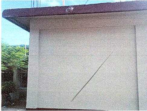
FOTO No. 7: Repello en muro
