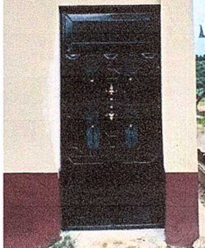
FOTO No. 1: Sustrucción de puerta (2.25m de alto * 0.99m de ancho)
