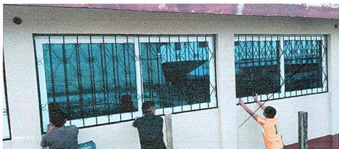
FOTO No. 3: Sustrucción de balcones de metal (1.35m de alto * 2.73m de ancho)
