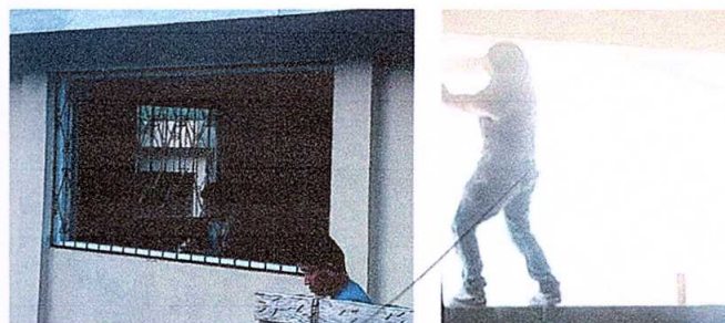
FOTO No. 2: Sustrucción de ventanas de madera por metal mas vidrio (1.35m de alto * 2.73m de ancho)
