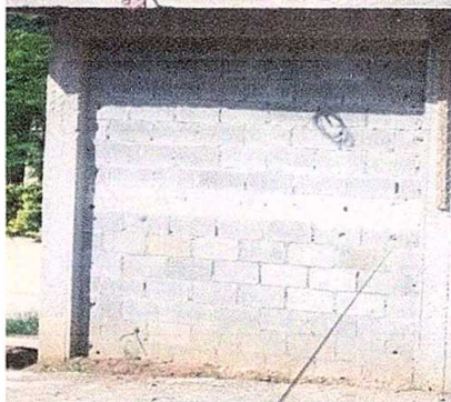
FOTO No. 7: Repello en muro
