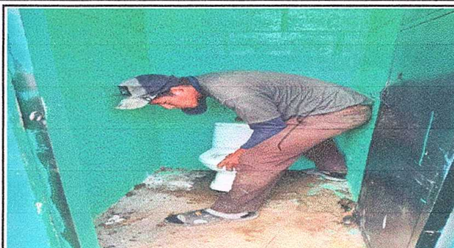
Foto 2: Servicio sanitario y sus accesorios
