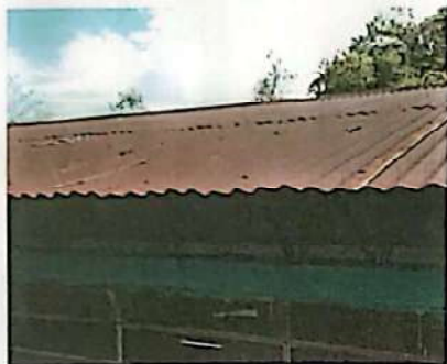
Foto1: LÁMINA, CAPOTE Y ESTRUCTURA EN MALAS CONDICIONES
