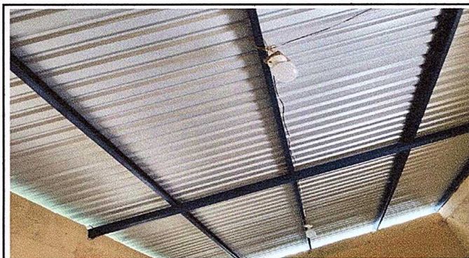
Foto 4: Cables y focos funcionando
