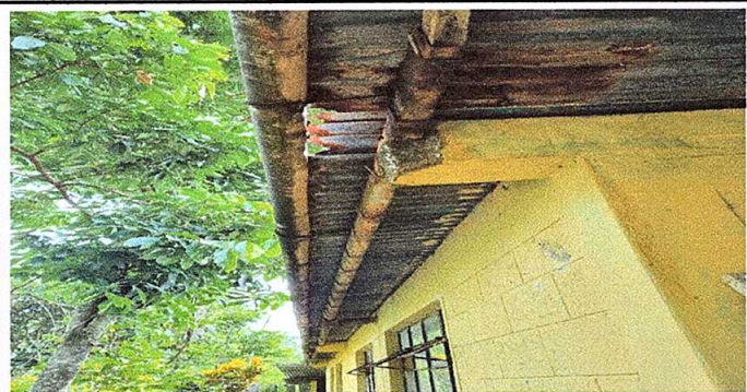
Foto 5: Canales que ya no funcionan
