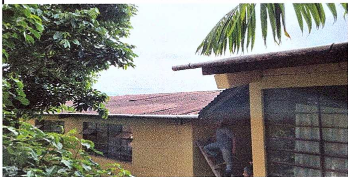
Foto1: Lámina en malas condiciones
