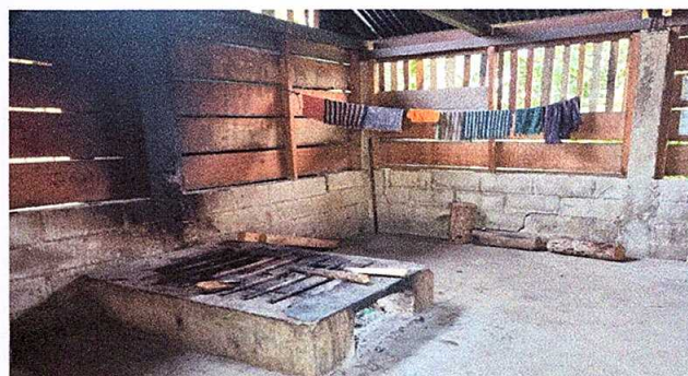
Foto 2 Cocina en malas condiciones
