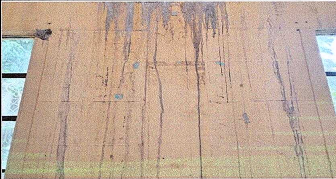
Foto1: Paredes pierden la pintura por la modificacion
