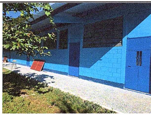
Foto 2: Puertas de metal sustitución de puertas: cuatro pueras están dañadas ya estan deterioradas (podridas) ya no cierran muy bien y tienen averturas.
