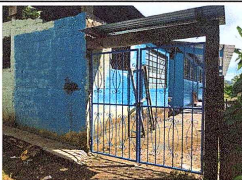
Foto 4: Sustitución de porton de metal. Se necesita cambiar el portón para resguardar la seguridad en los estudiantes.
