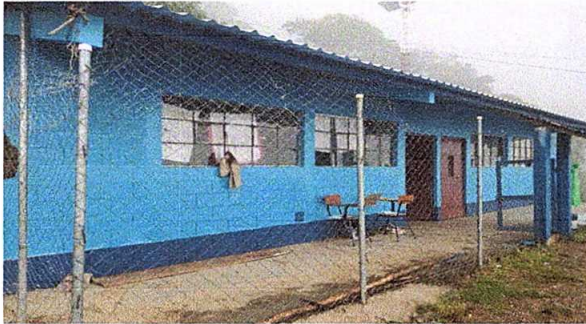
Foto 7: Pintura en muros exteriores e interiores deteriorada
