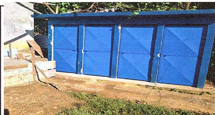
Foto 3: Sustitución de puertas en servicios sanitarios. Cuatro puertas deterioradas se necesita un cambio.
