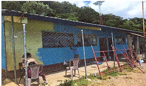
Foto 7: Pintura en muros exteriores e interiores deteriorada
