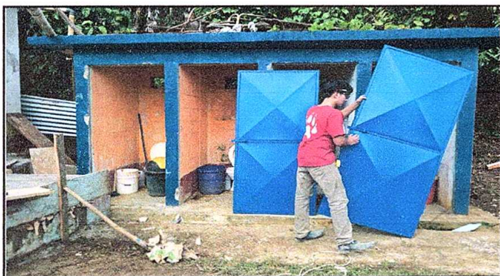
Foto 3: Sustrucción de puertas en servicios sanitarios. Cuatro puertas deterioradas se necesita un cambio.
