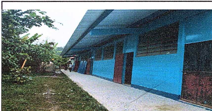
Foto 2: Puertas de metal sustrucción de puertas: cuatro puertas están dañadas ya están deterioradas (podridas) ya no cierran muy bien y tienen averías.
