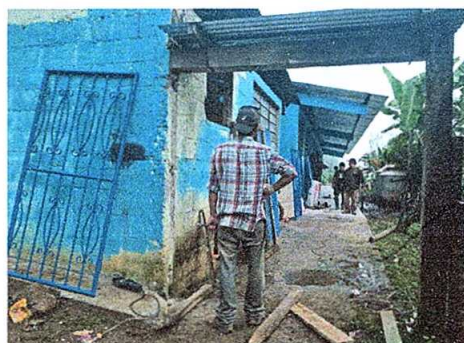
Foto 4: Sustrucción de portón de metal. Se necesita cambiar el portón para resguardar la seguridad en los estudiantes.
