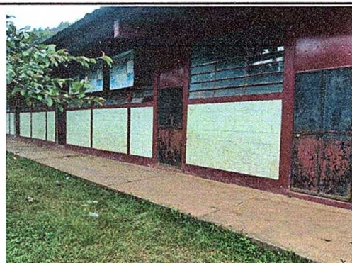
Foto 2: Puertas de metal sustrucción de puertas: cuatro puetras están dañadas ya estan deterioradas (podridas) ya no cierran muy bien y tienen averturas.
