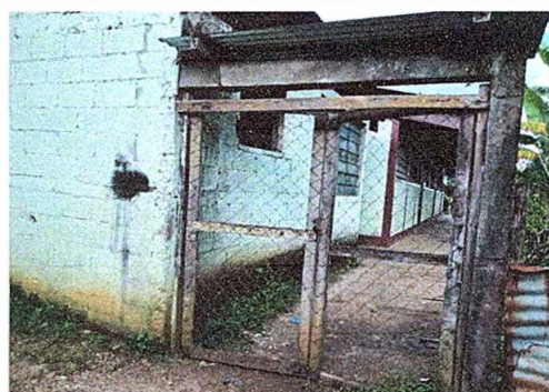
Foto 4: Sustrucción de porton de metal. Se necesita cambiar el portón para resguardar la seguridad en los estudiantes.
