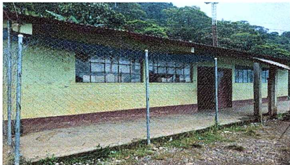
Foto 7: Pintura en muros exteriores e interiores deteriorada
