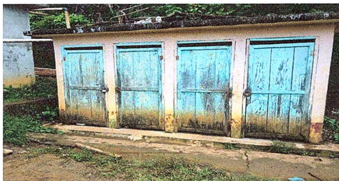
Foto 3: Sustrucción de puertas en servicios sanitarios. Cuatro puertas deterioradas se necesita un cambio.
