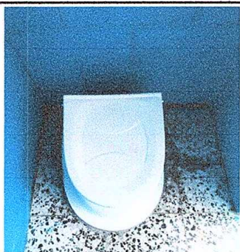
FOTO No. 5: Sustrucción de inodoro.
