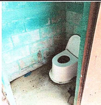
FOTO No. 5: Sustrucción de inodoro.
