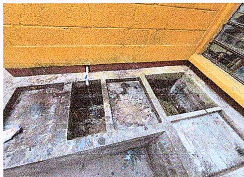
Foto 4: Instalación de azulejo en pilas en mal estado.
