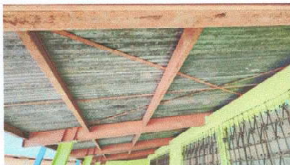
Foto 2: estructura de metal en malas condiciones
