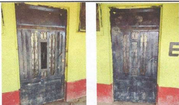
Foto 3: Puertas y chapas en mal estado
