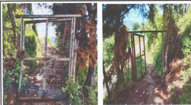
Foto 4: porton de entrada de la escuela de madera en mal estado
