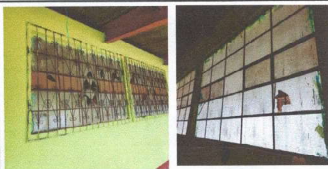
Foto 5: vidrios opacos y en mal estado.
