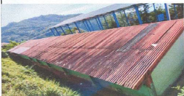
Foto1: Lámina en malas condiciones
