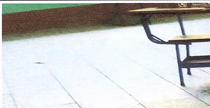
Foto 1: Sustrucción de piso de granito
