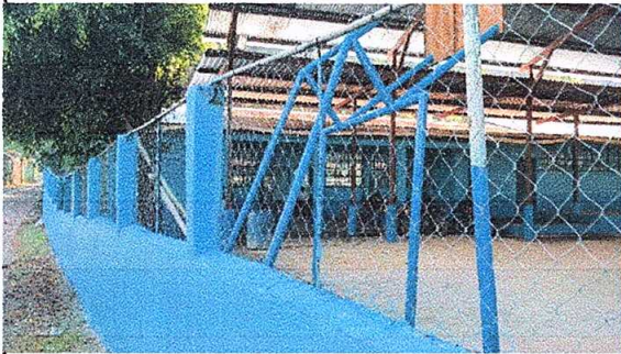
Foto1: Malla galvanizada detereorada
