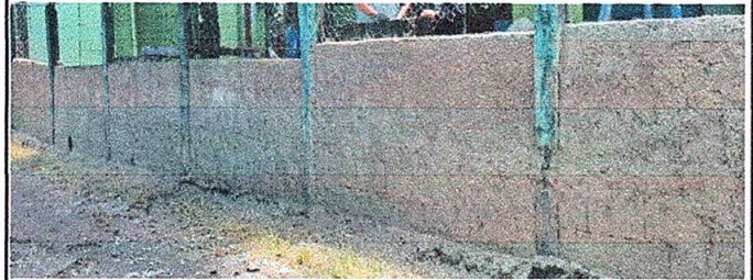
Foto 2: Muro necesita repello
