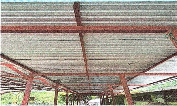
Foto1: Lamina en malas condiciones
