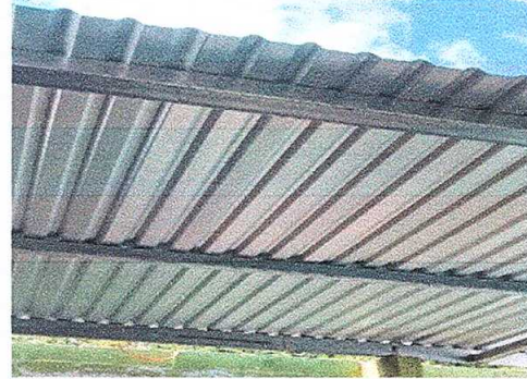
Foto 2: Estructura de techo en mal estado
