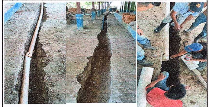
Foto 6: Estado de tubo de agua pluvial en mal estado
