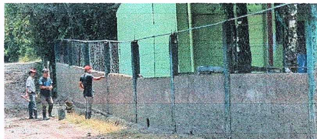
Foto 2: muro necesita repello
