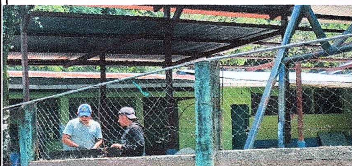
Foto 1: malla galvanizada deteriorada
