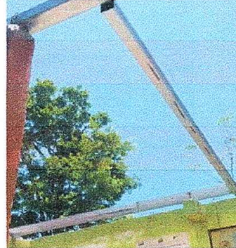
Foto 2: Estructura de techo en mal estado
