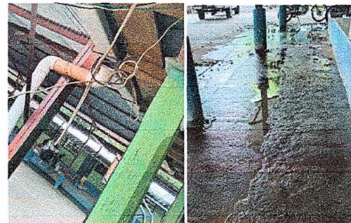
Foto 6: estado de tubo de agua pluvial en mal estado
