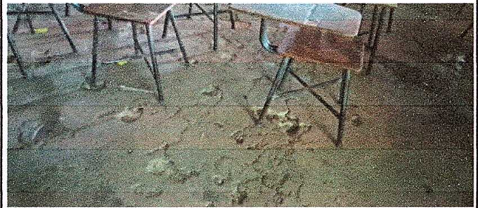
Foto 4: el estado del piso esta en malas condiciones
