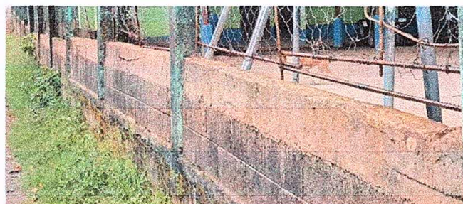
Foto 2: muro necesita repello
