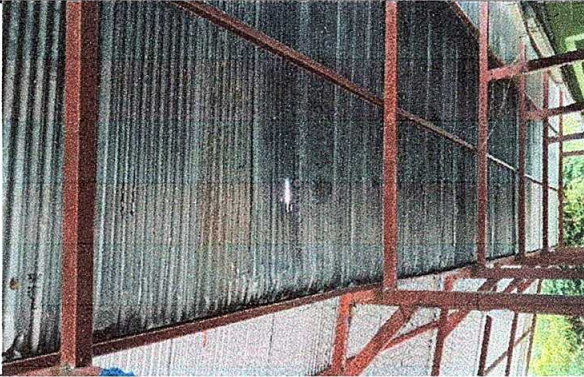
Foto 1: Lámina en malas condiciones
