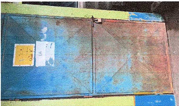
Foto 3: pintura de puertas en mal estado y necesita lijado
