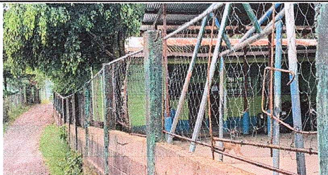
Foto 1: malla galvanizada deteriorada
