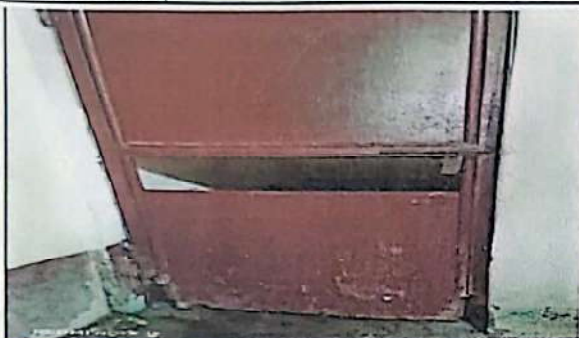
Foto 1: Puerta de sanitario
