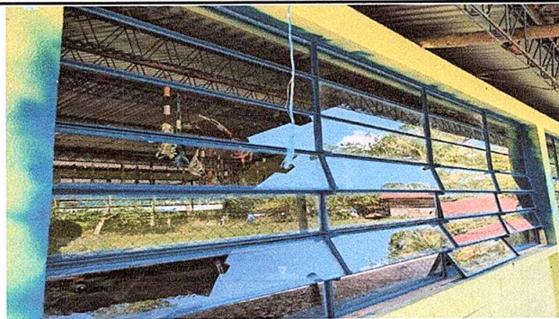
Foto 5: Estructura de ventana en mal estado
