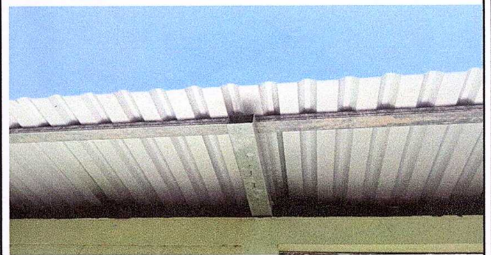
Foto 2: Estructura de madera en malas condiciones
