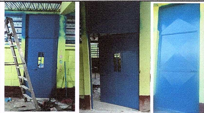
Foto 3: Una puerta para mantenimiento y sustitución de 3 puertas
