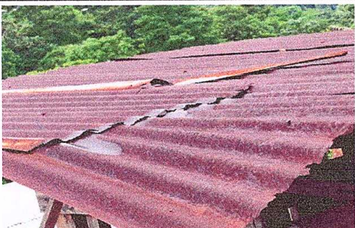
Foto1: Lámina en malas condiciones
