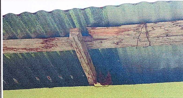
Foto 2: Estructura de madera en malas condiciones
