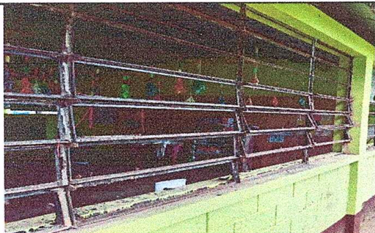
Foto 5: Estructura de ventana en mal estado
