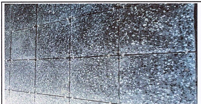
Foto5: Sustrucción de piso de granito.
