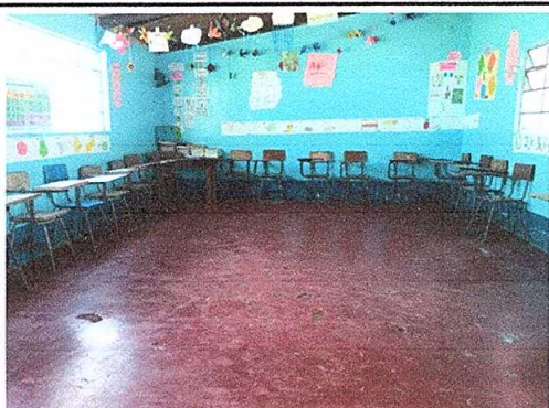
Foto 3: Sustrucción de piso de torta de concreto
