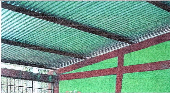
Foto 1. Lámina en malas condiciones
