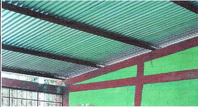
Foto 1. Lámina en malas condiciones
