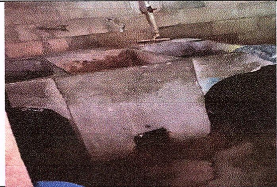
Foto 2: pila destruida y en malas condiciones
