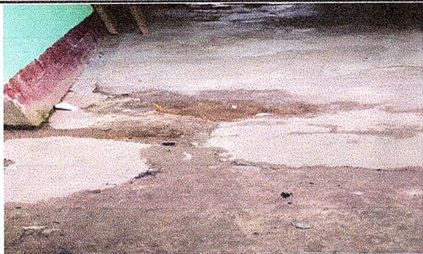
Foto 3: repacion de piso en malas condiciones
