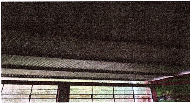
Foto1: Lámina en malas condiciones
