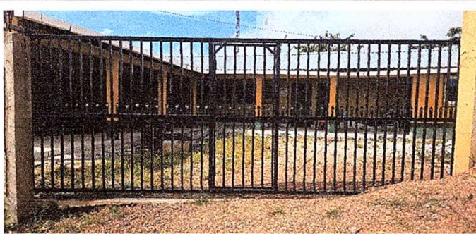
Foto 3: PUERTAS DE METAL
