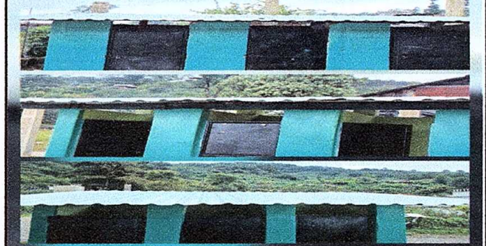
Foto 2: Lámina sanitarios RENGLÓN 1
