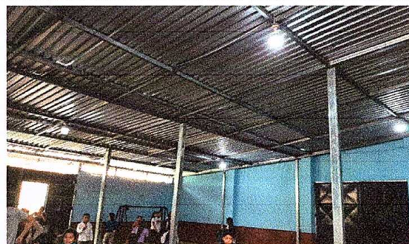
Foto 10: Sistema eléctrico, plafoneras, lámparas, toma corriente, interruptor, cableado eléctrico
