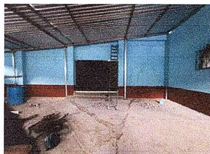
Foto 10: Sistema eléctrico, plafoneras, lámparas, toma corriente, interruptor, cableado eléctrico
