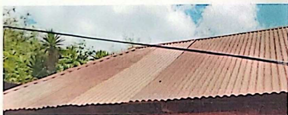
Foto 3: Techo en malas condiciones
