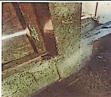
Foto 4: paredes en mal estado
