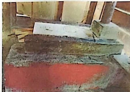
Foto 2: Plancha en malas condiciones y no es suficiente
