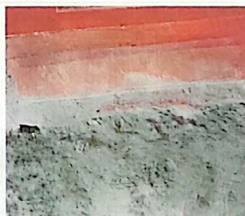
Foto 6: piso en mal estado
