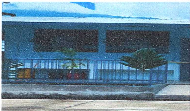
Foto1: Mejoramiento de ventanas de metal en cocina de 1.13 metros de ancho por 1.20 metros de alto.
