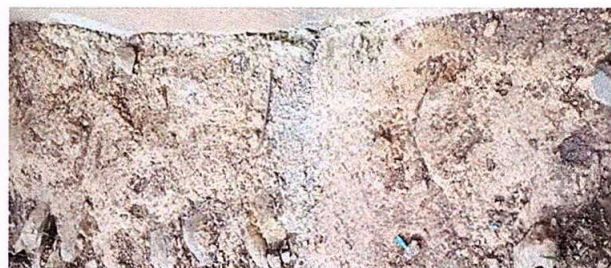
Foto 4: Losa de patio en mal estado
