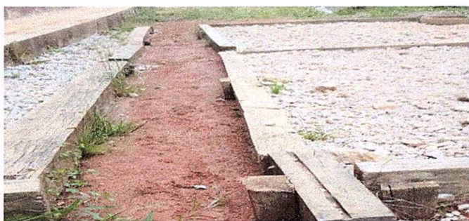
Foto 3: Banquetas en mal estado
