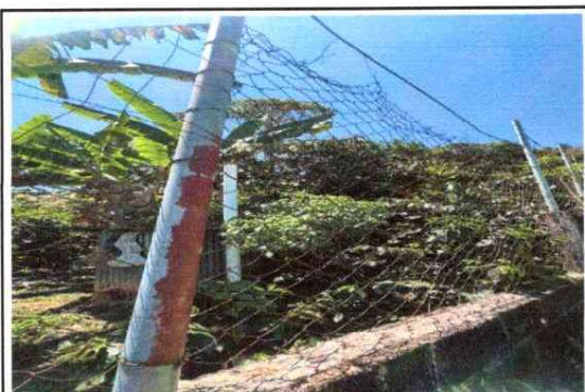
Foto 13: TUBOS Y MALLA EN MAL ESTADO
