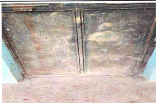
Foto 3: PUERTA DE COCINA DAÑADA
