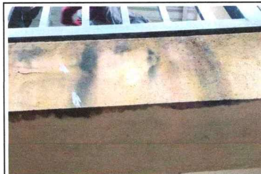
Foto14: PINTURA DE PAREDES INTERIORES Y EXTERIORES DETERIORADAS DEL INSTITUTO
