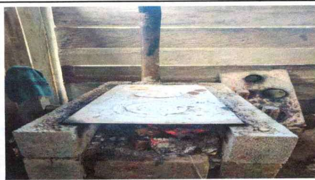
Foto 8: ESTUFA RURAL EN MAL ESTADO
