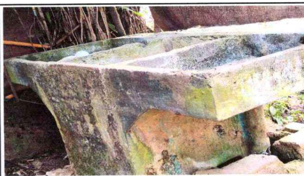
Foto 10: PILA DE CEMENTO DE DOS LAVADEROS DETERIORADA Y CON FILTRACIÓN DE AGUA
