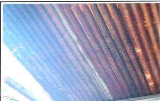
Foto1: LÁMINA DE TECHO DEL PATIO DAÑADA
