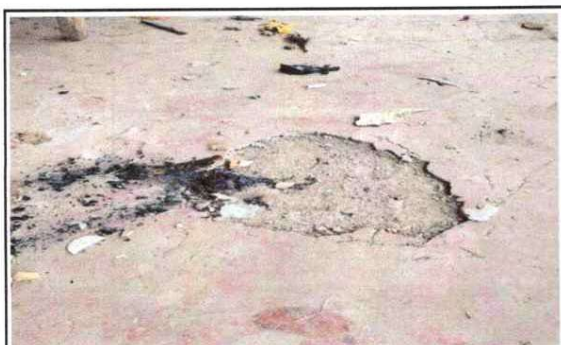
Foto 5: PISO DE COCINA DAÑADO
