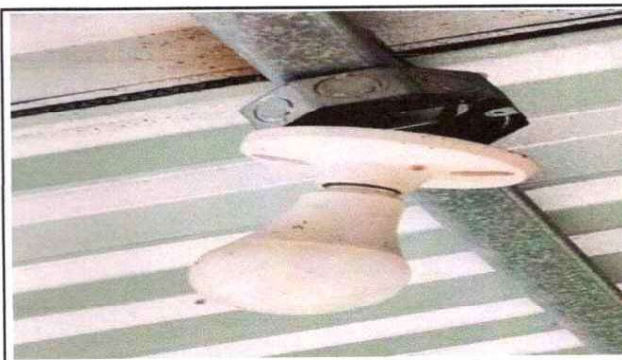
Foto 12: SISTEMA ELECTRICO DE ENTECHADO DE PATIO EN MAL ESTADO
