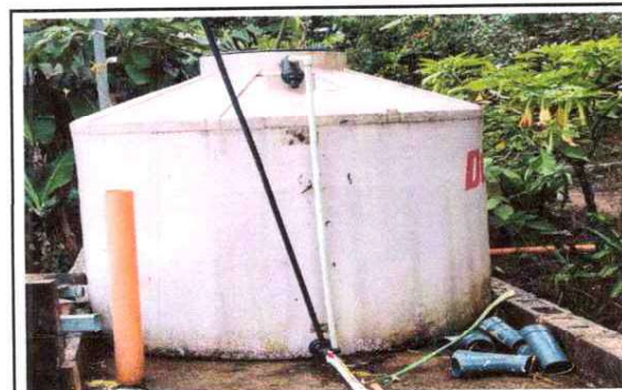
Foto 11: DEPÓSITO DE AGUA CON FUGA POR LACERACIÓN
