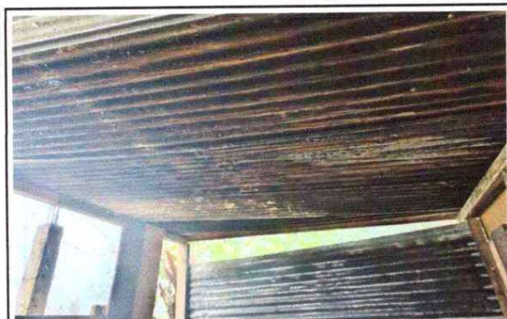
Foto 9: COCINA EN MAL ESTADO
