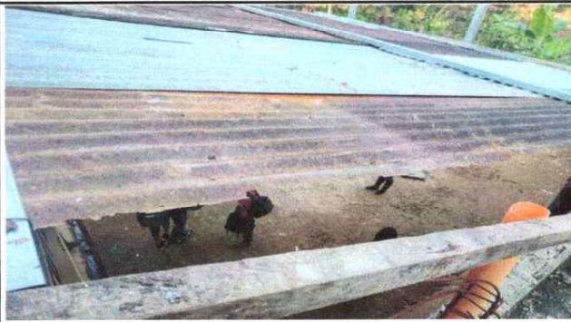
Foto 2: SOPORTES DE TECHO DAÑADOS Y DE MADERA
