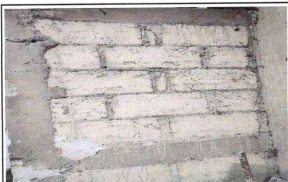
Foto7: GRIETAS Y FISURAS EN MUROS DE LA COCINA
