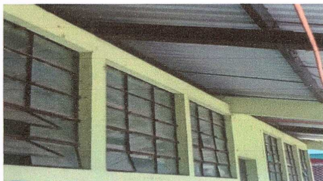
Foto 4: Sustrucción de estructura de metal de ventana
