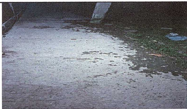
Foto 5: Sustrucción de piso de torta de concreto
