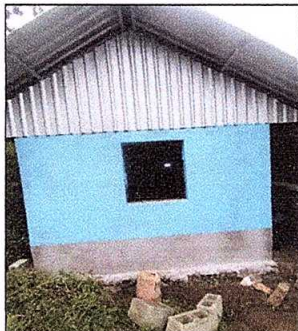
Foto 7: Pintura en paredes de cocina.
