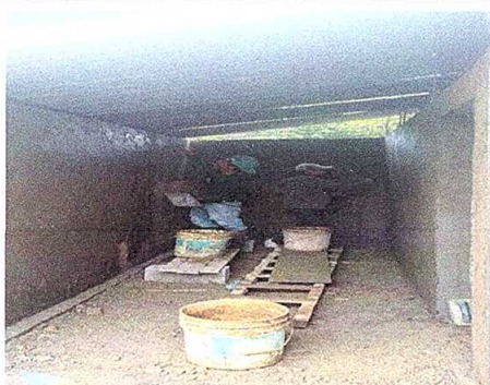
Foto 11: REPELLO EN PARED DE BAÑOS
