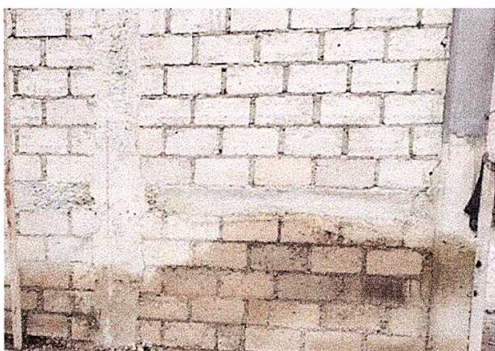
Foto 11: REPELLO EN PARED DE BAÑOS
