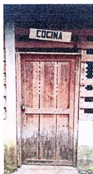
Foto 3: Puerta de madera en mal estado.
