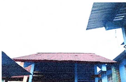
Foto1: Lámina en malas condiciones.
