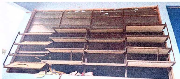
Foto 4: Inexistencia de balcones de metal en ventanas.
