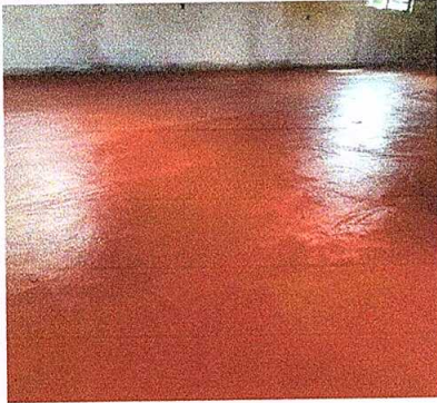
Foto7: Sustrución de piso de concreto o granito.
